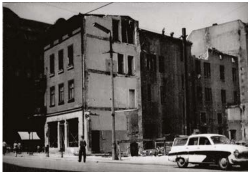
23. Rozbiórka kamienicy na rogu Świętego Marcina (Czerwonej Armii) i Gwarnej (Lampego) – przygotowania pod budowę II etapu „Alfy”
